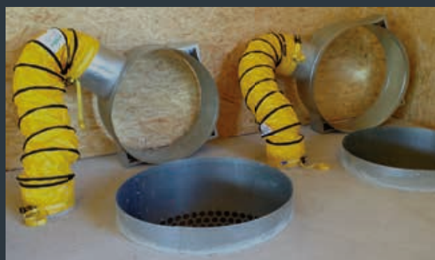
La conduite de répartition d'air alimente la deuxième rangée de séchage.
