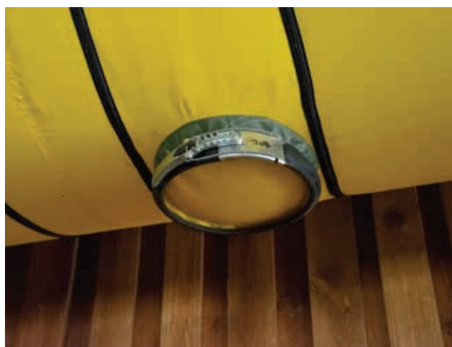
Les sorties d'air sur la conduite principale peuvent être obstruées si elles ne sont pas utilisées.
