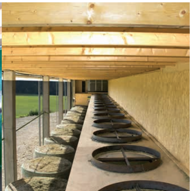
Sur le côté du bâtiment, canal en tôle pour le séchage de balles rondes avec déshumidificateur d'air et rideau automatique.
